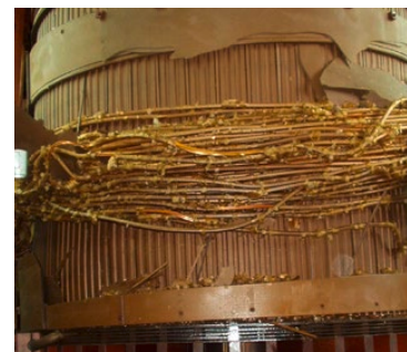
Обмотка с деформированным отводом
